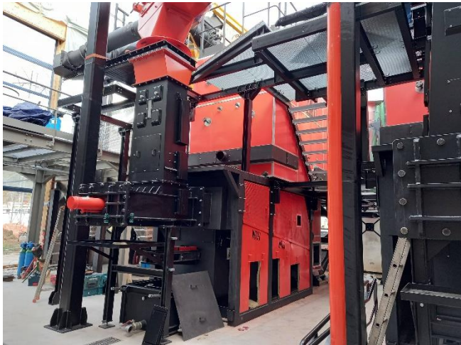
Chaudière n°1 1650 kW
