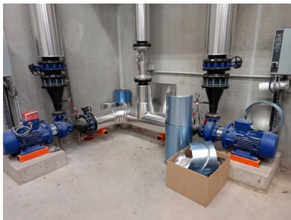
Pompes de charge chaudière gaz
