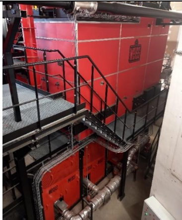
Chaudière n°2 2700 kW
