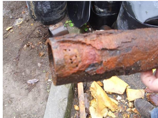
Corrosion sur piquage
