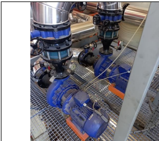
Pompes de charge chaudière bois
