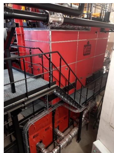
Chaudière n°2 2700 kW
