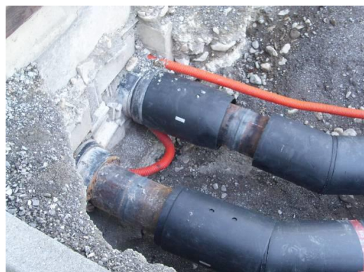
Fuite sortie chaufferie
