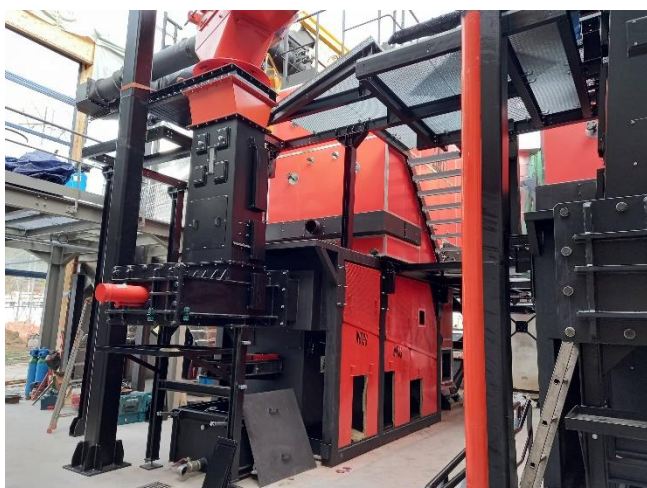
Chaudière n°1 1650 kW
