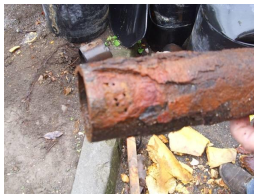
Corrosion sur piquage
