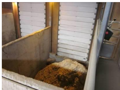
Trémie de déchargement
